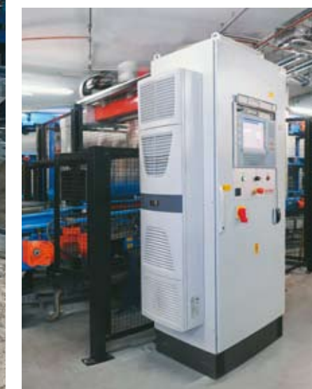
Bei den Gepäckförderanlagen kommen auch zahlreiche TS 8 Schaltschränke mit TopTherm-Kühlgeräten zum Einsatz.
